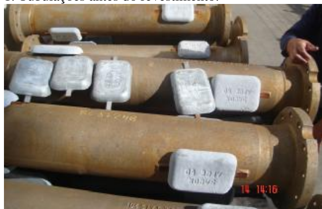
2. Desgastes internos e no flange.
