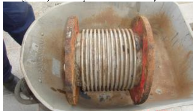
2. Notar desgastes (corrosão severa).
